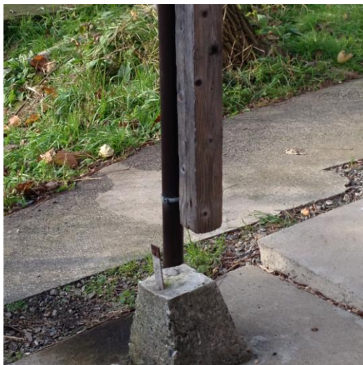
③腐敗した配管
