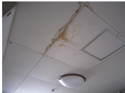
④天井の雨漏り
